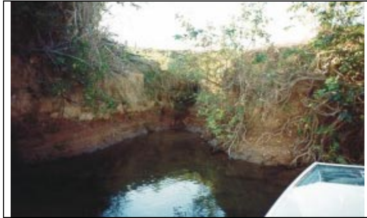
Figura 15. Erosão por piping em estágio bem desenvolvido na margem da Ilha Floresta. Foto do autor (Setembro/2003)
