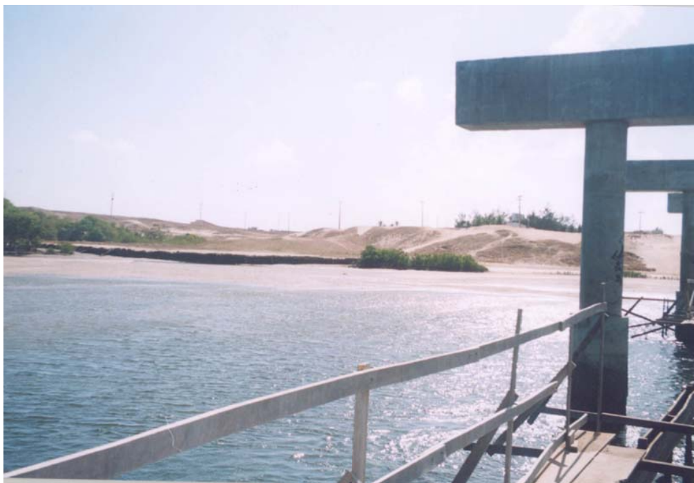
Foto 17 – Aspecto da construção da ponte sobre o Rio Cocó. O percurso da via de acesso foi aberto sobre a margem direita e dunas de Sabiaguaba, com a retirada de cerca de 200 metros de apicum e cobertura de mangues.
