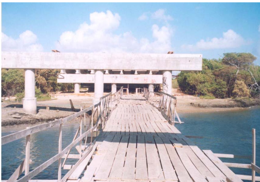
Foto 18 – Passarela de acesso às obras incompletas da ponte. A estrutura impede a passagem de embarcações pelo canal do Rio Cocó. Retirada de cobertura do mangue e apicum para dar passagem à construção. Margem esquerda do estuário (Caça e Pesca).
