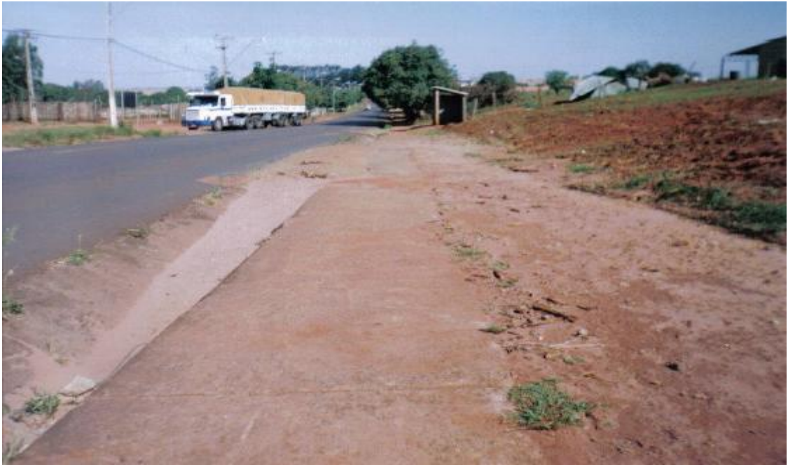
Figura 31 – Fonte 06 - Asfalto corroído por erosão em solo arenoso. Foto: Pimenta, Março 2005.
