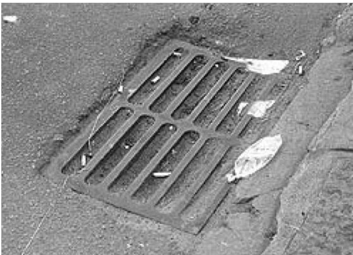
Figura 33 – Fonte 7 – Problemas de escoamento pluvial, bueiro Entupido. Galeria pluvial. Foto: Pimenta, Abril de 2003.
