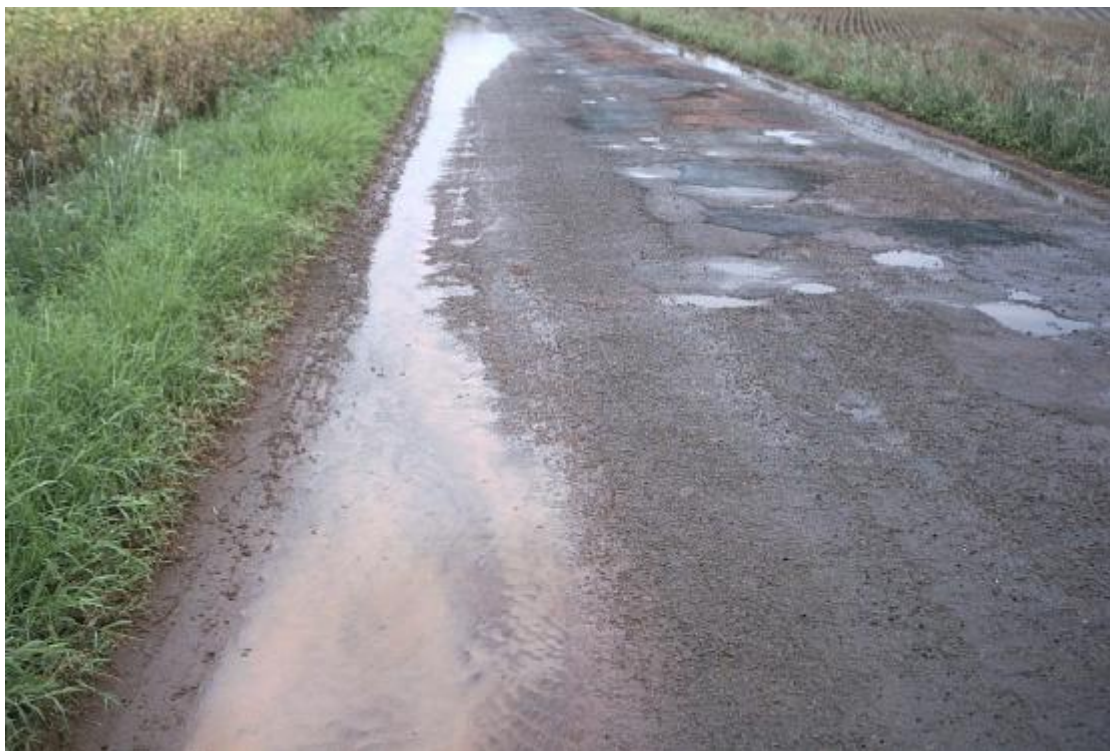
Figura 34 – Fonte 8 – Estrada rural degradada por erosão devido a concentração das águas pluviais nas margens. Foto: Pimenta, Março de 2006.
