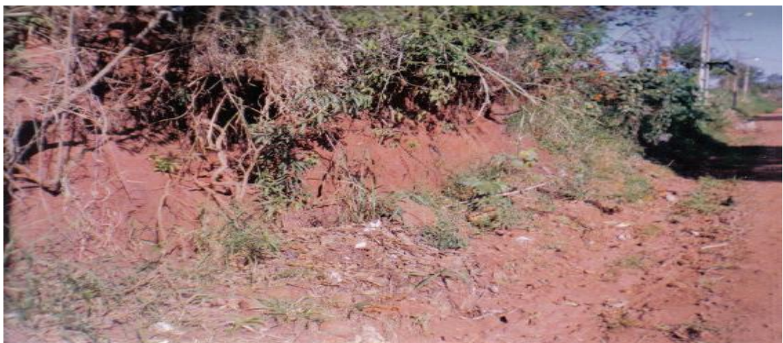
Figura 28 – Fonte 4 – Trecho da rua que liga Bela Vista ao Distrito de Santa Margarida, degradada por erosão acelerada e falta de pavimentação asfáltica, Foto: Pimenta, Abril de 2005.
