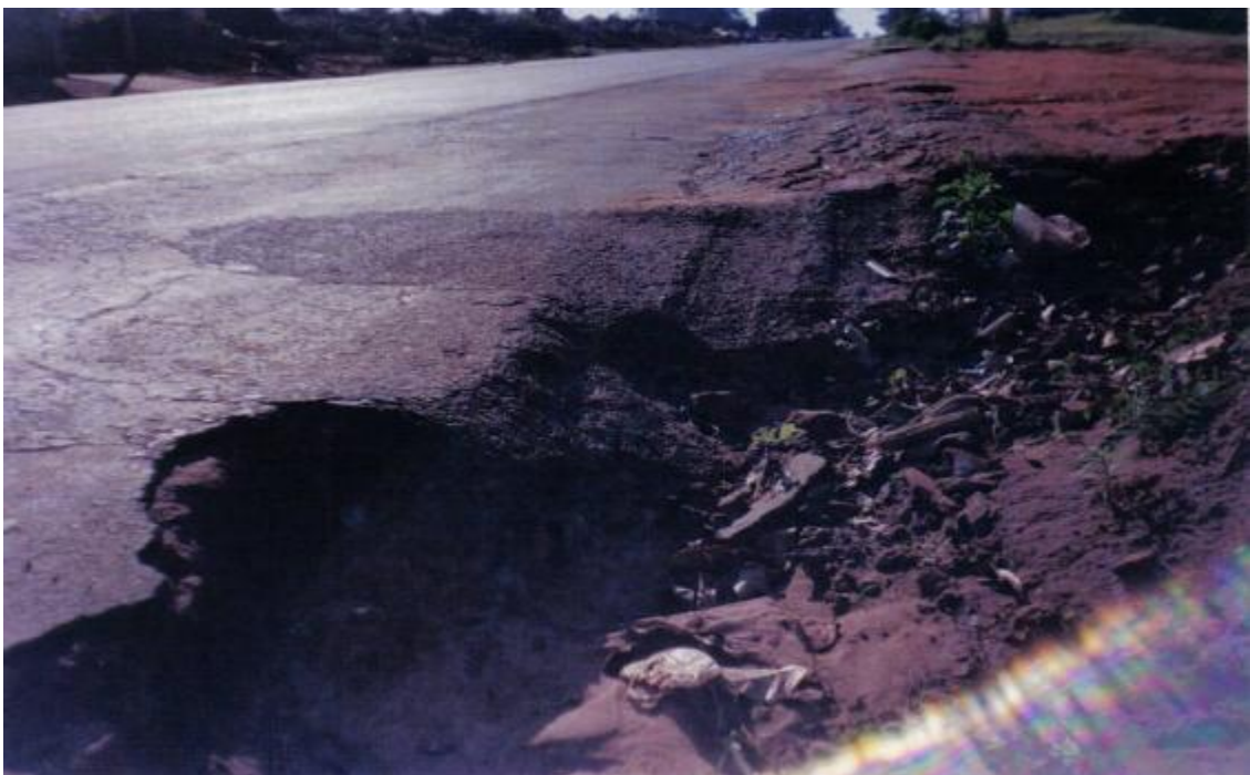
Figura 32 – Fonte 6 – Erosão na margem de rodovia corroendo o asfalto. Foto: Pimenta, Março de 2005.
