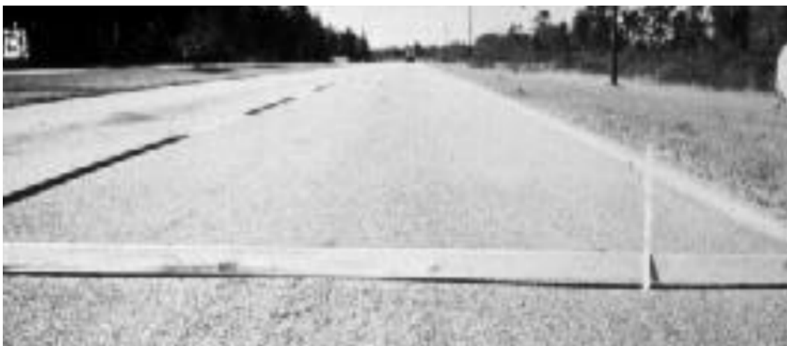
Foto 2: deformação permanente nas trilhas da roda.
