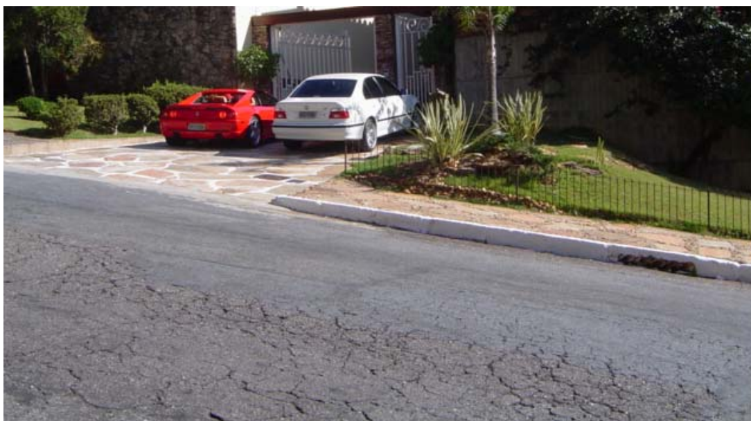
Foto 1: Trincas por fadiga.
