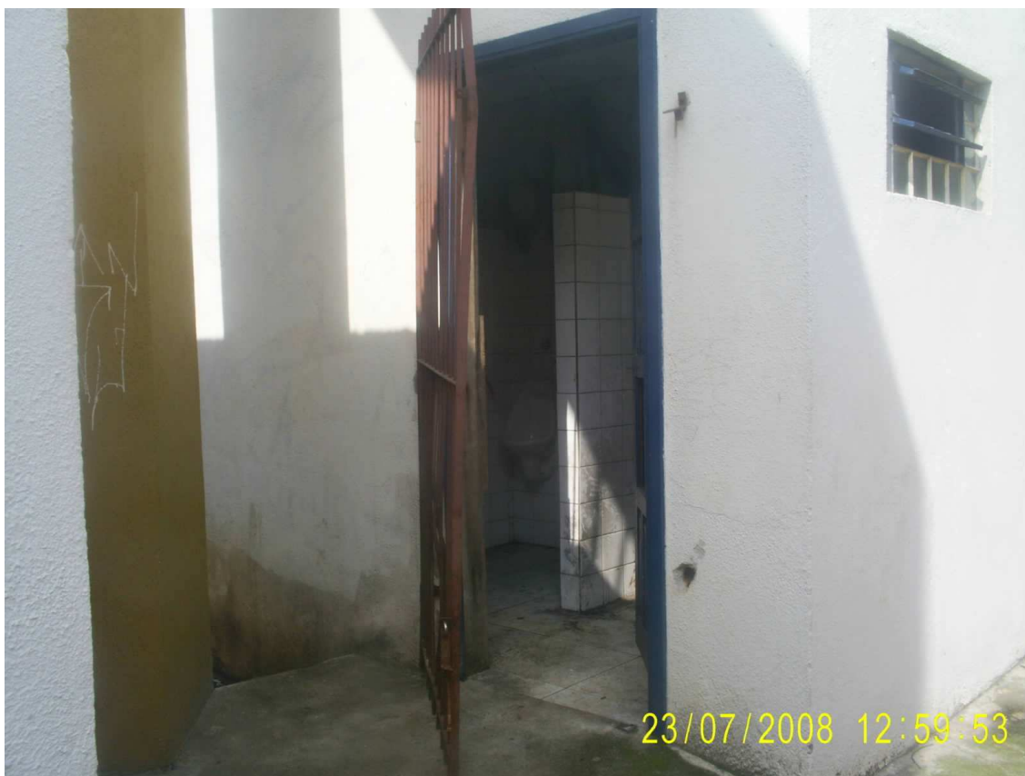
Banheiros da Praça do Verbo Divino – precárias condições.
