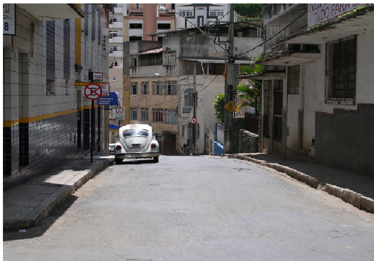
Figura 5: Foto de rua com calçada deficiente no centro da cidade. (Foto de Daniel L. Casteluber. 2006)
